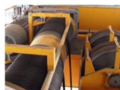
Windwerk im Kran
